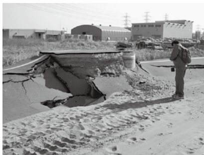
図2 液状化による構内道路の損傷
