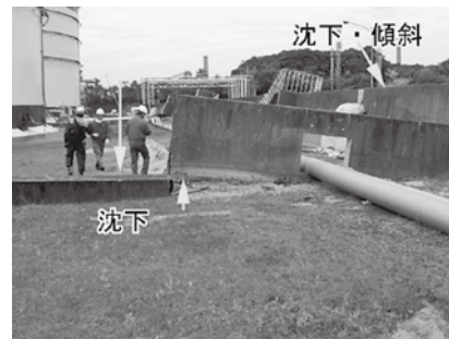
図3 防油堤の沈下・傾斜の例
