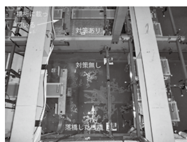
図9 栈橋の損傷状況
